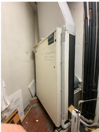
[Foto 1 – Condizionatori di precisione esistenti nel vano tecnico]
