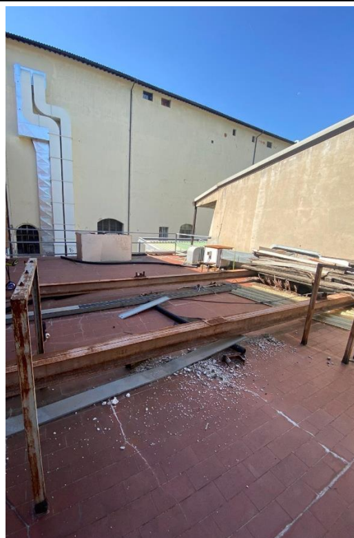
[Foto 6 – vista frontale, area destinata al posizionamento delle pompe di calore]
