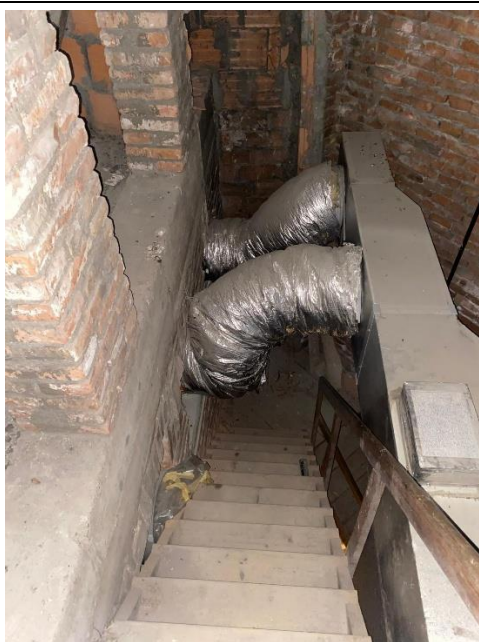
[Foto 3 – Condotte flessibili di collegamento fra plenum e ugelli]
